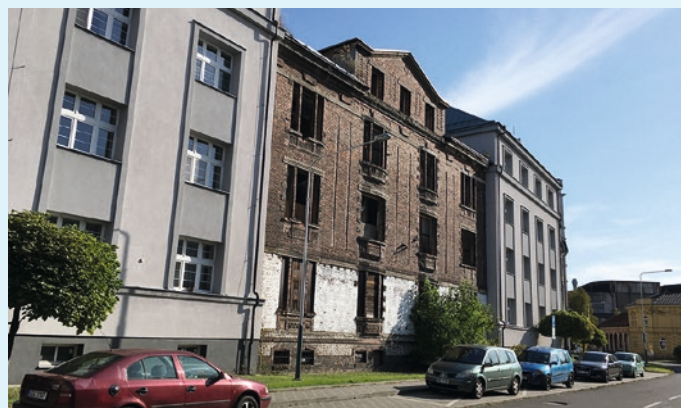
Zdevastovaný objekt v ulici Štramberské 10 čeká rekonstrukce
